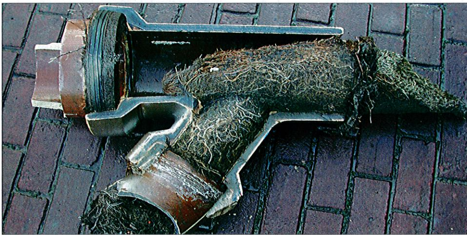
Abb. 1: Ein durch Wurzeinwuchs vollständig ausgefüllter, funktionsunfähiger Abzweig
