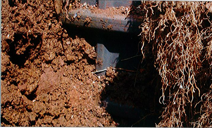
Abb. 2: Durch Wurzelrückschnitt während des Einbaus verursachte Regeneration in unmittelbarer Nähe eines Schachtes
